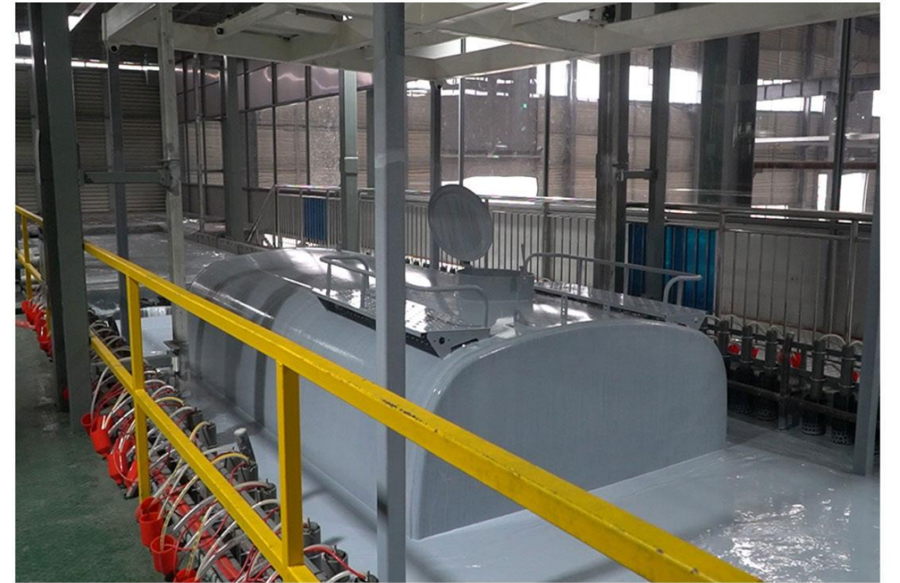
电泳涂装生产线-3
