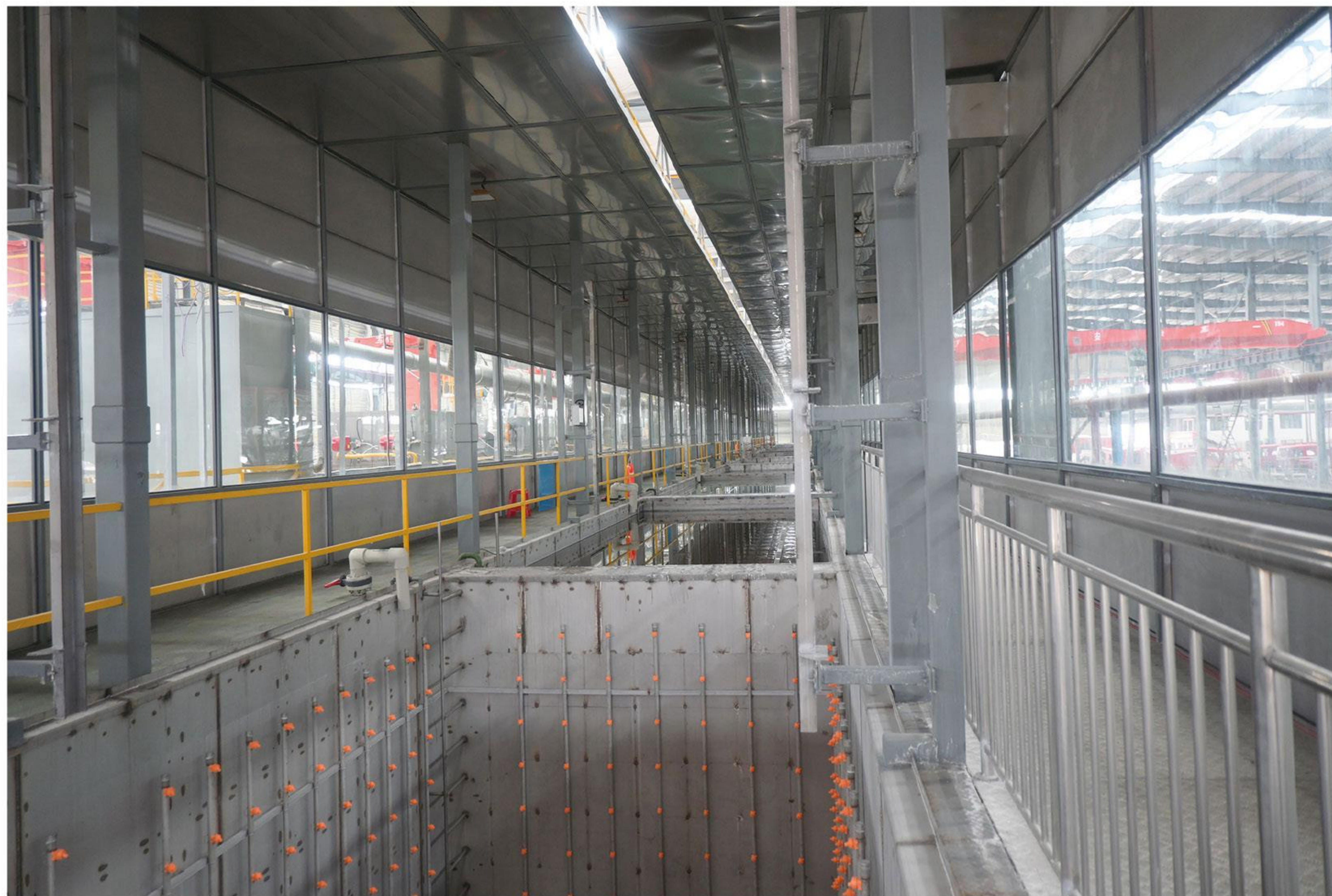
电泳涂装生产线-4
